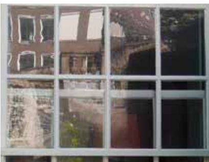
Vervormingen in verschillende soorten vensterglas, Huis van Brienen, Amsterdam
